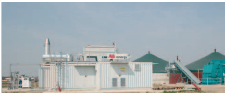
Equipo Ecomax Bio de 300 kW de Gruppo AB en una planta de biogás por digestión anaeróbica.
