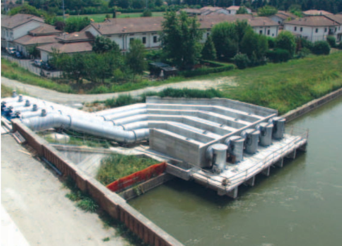
Instalación de cinco bombas de hélice Flygt modelo PL 7081. Caudal máx. 2 m 3 /seg. y Potencia: 200 Kw.
